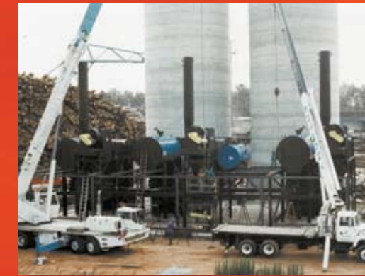
Triple 600 BHP Aserradero de pino Aplicación de calor de hornos secos de "serpentin" de vapor.
