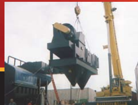
Recolectores dobles de cenizas Unidades modulares primaria y secundaria siendo levantadas en el lugar.
